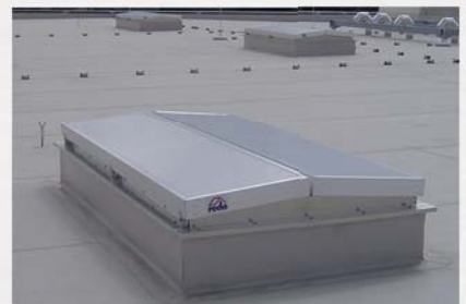
Einzelgerät auf einem Industriedach
