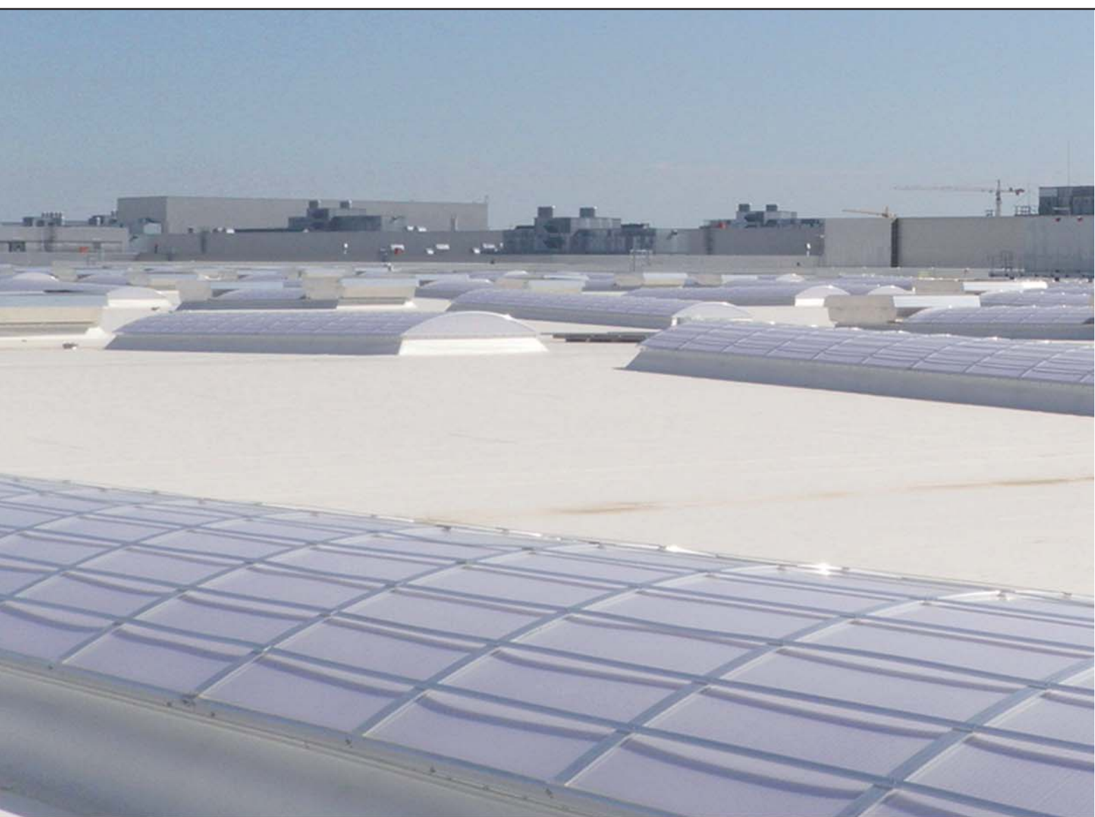
Großes Bild: EUROLIGHT mit Durchsturzicherung Typ PSP30 auf der großen Produktionshalle eines Automobilherstellers.
